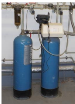
Obrázek 18 – Úpravna vody v pavilonu V
