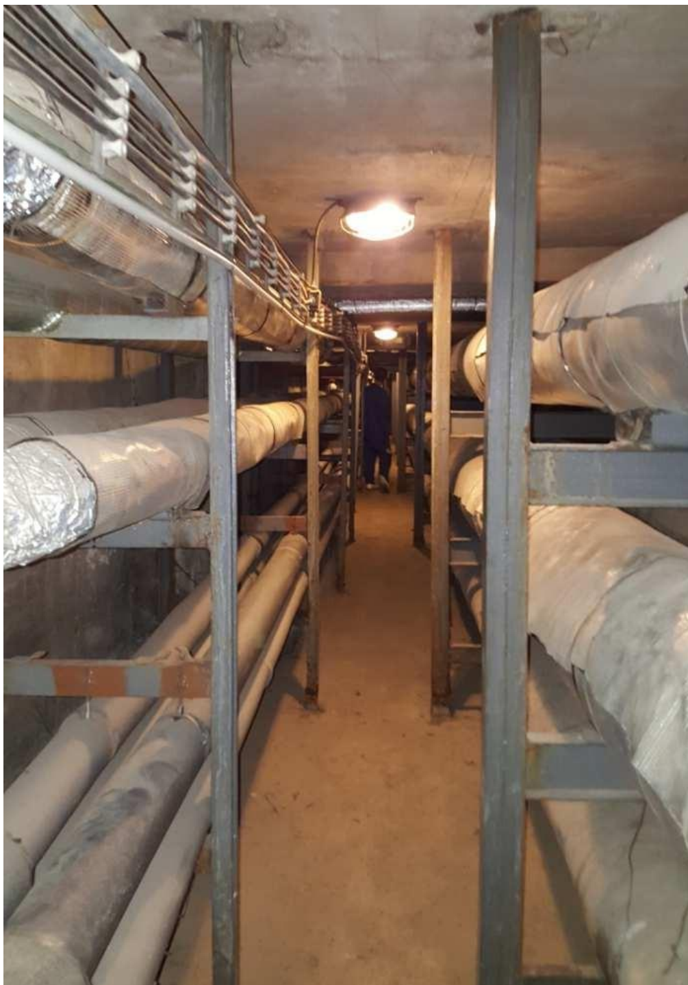
Pohled do energo kolektoru
