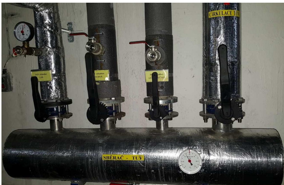
Pohled na sběrač cirkulace teplé vody
