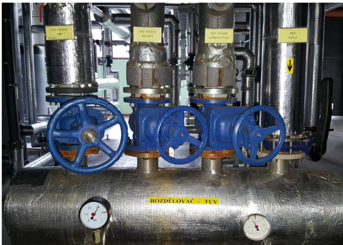
Pohled na rozdělovač teplé vody
