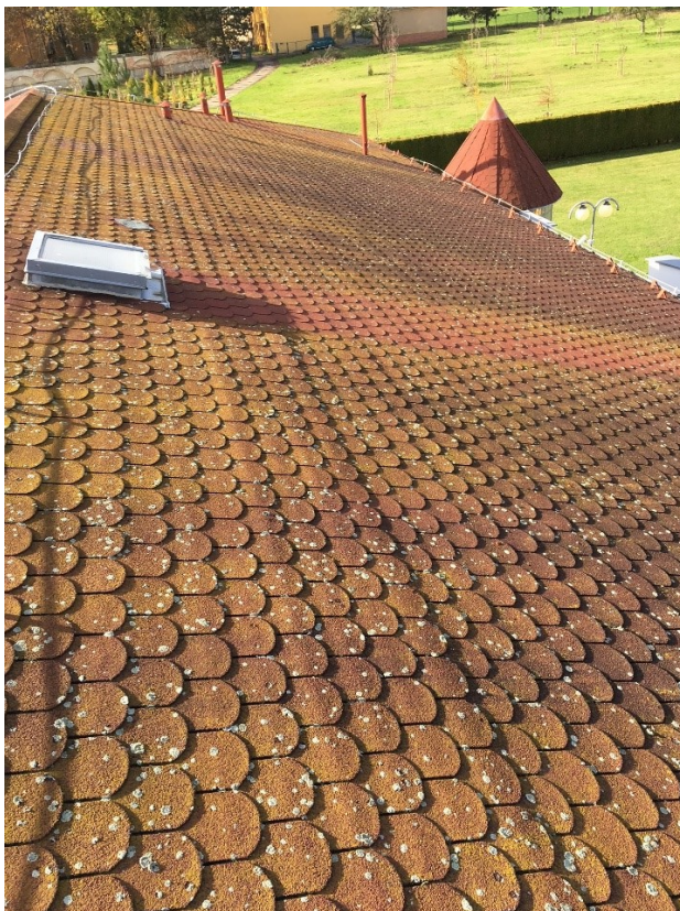
Obrázek 1 - krytina střechy – stávající stav
