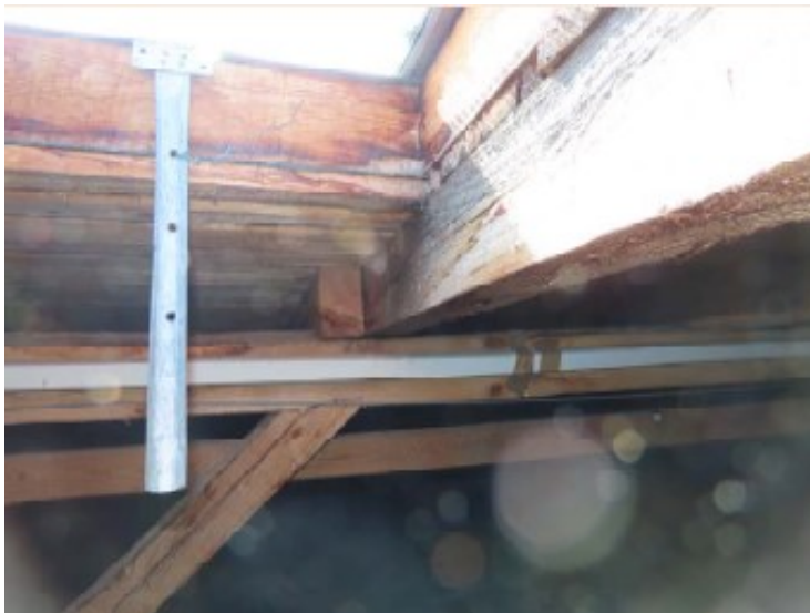
Obrázek 2 - zatékání kolem střešního výjezu
