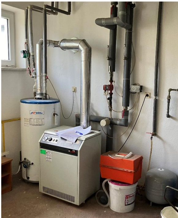
Obrázek 1 - Stávající plynové zařízení - Hlučín
